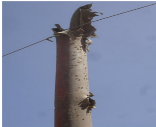
یکی از پایه های برق در شهر کابل که پیکرش در جنگهای تنظیمی سوراخ سوراخ شده
